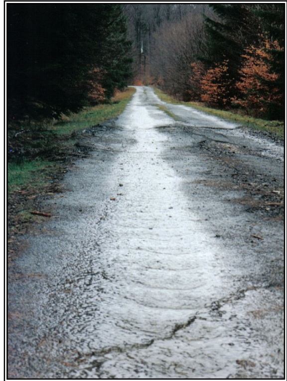
Bild 3-19 Oberflächenabfluss auf versiegeltem Forstweg an der Westgrenze des Modellhanges Hölzerkopf.
