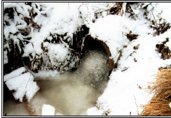
Bild 4-2 Abflussmessstelle W9a mit starker Eisbildung im Februar 2000.
