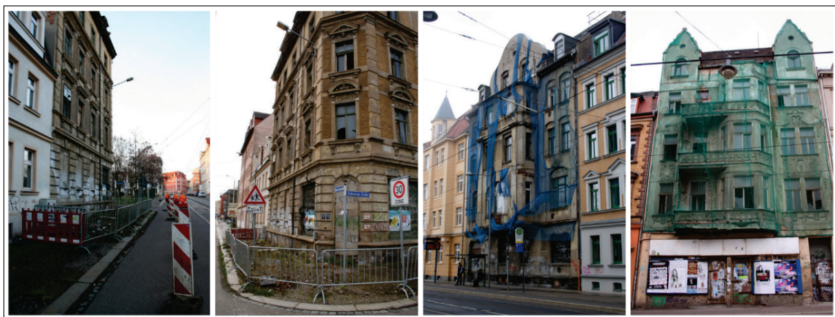
Abb. 12: Absperrung und Sicherung von Gammelimmobilien zwecks Gefährdung der Öffentlichkeit Quelle: eigene Aufnahmen
