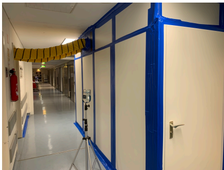
Abbildung 9: Installation von Be- und Entlüftungsrohren im Rahmen einer Baustelle mit fester Staubschutzwand in sensiblen OP-Bereich
