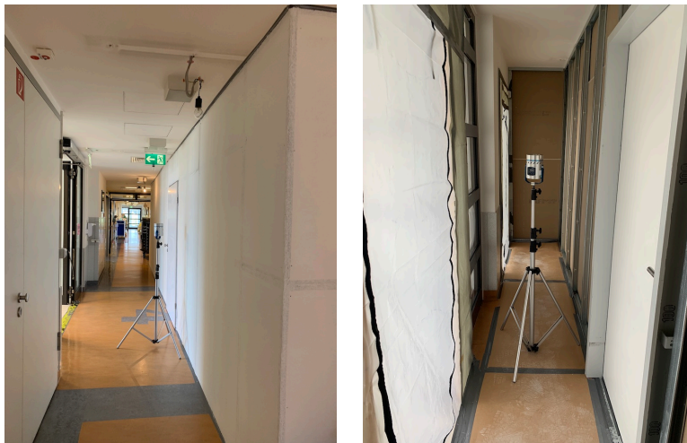
Abbildung 11: linkes Foto: Installation einer festen Staubschutzwand mit integrierter Tür rechts; rechtes Foto: innerhalb der Baustelle mit fester Wand rechts und dicken Staubschutzfolien links
