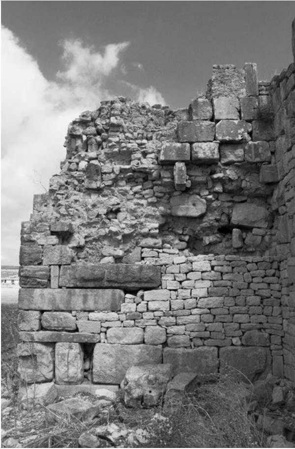
Abb. 347 Agbia. Westkurtine mit nach Westen umknickenden Abschnitt und freiliegendem Schuttmauer- kern, darunter die moderne Restaurierung
