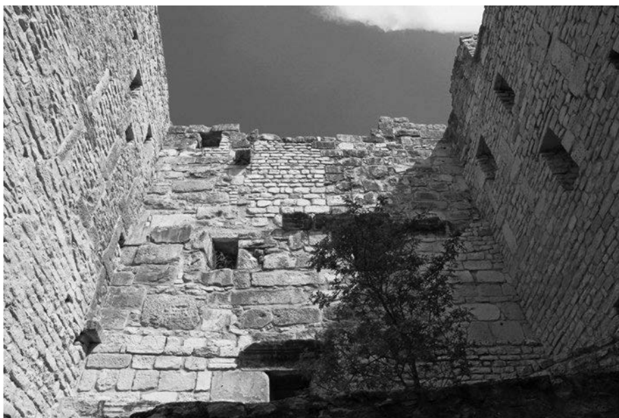
Abb. 326 Thignica. Turm C stark restaurierte Bausubstanz der inneren Ostwand mit Schießscharten
