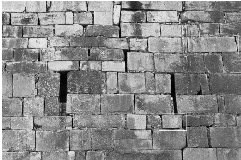
Abb. 332 Thignica. Ostseite von Turm C mit Fragmenten einer Inschrift (CIL VIII 1412 = 15204) im Mauerverlauf bzw. als Teil der Schießscharte im zweiten Obergeschoss
