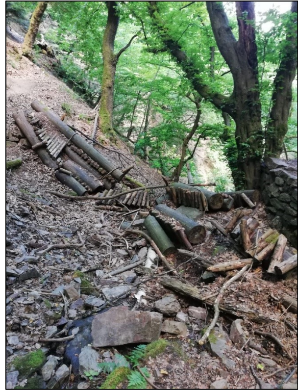
Abb. 49: Durch Murgang zerstörte Fußgängerbrücke in der Kreuzbachklamm (Foto: Hagge-Kubat 2020)
