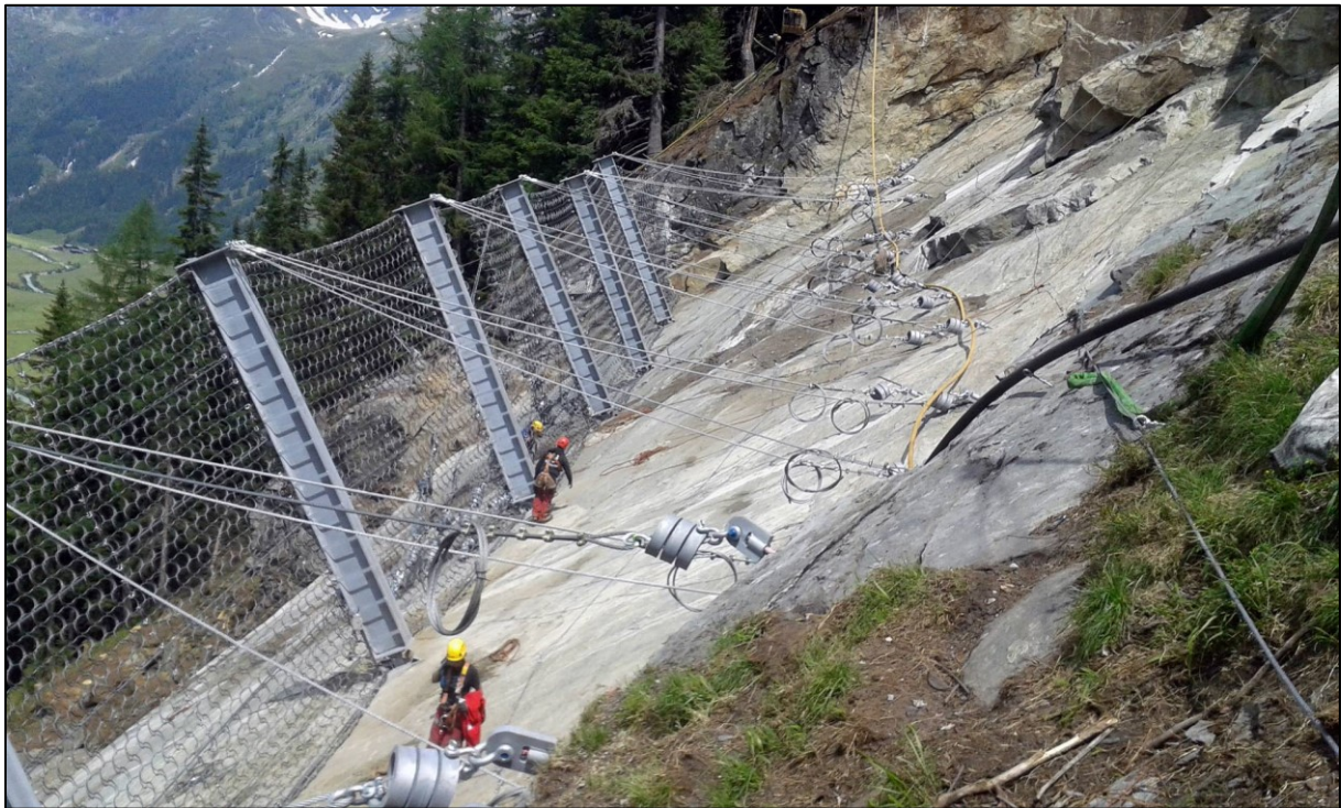
Abb. 10: Rückabgespannter Steinschlagfangzaun an einem Felshang in der Schweiz (Foto: Trumer Schutzbauten o.J)
