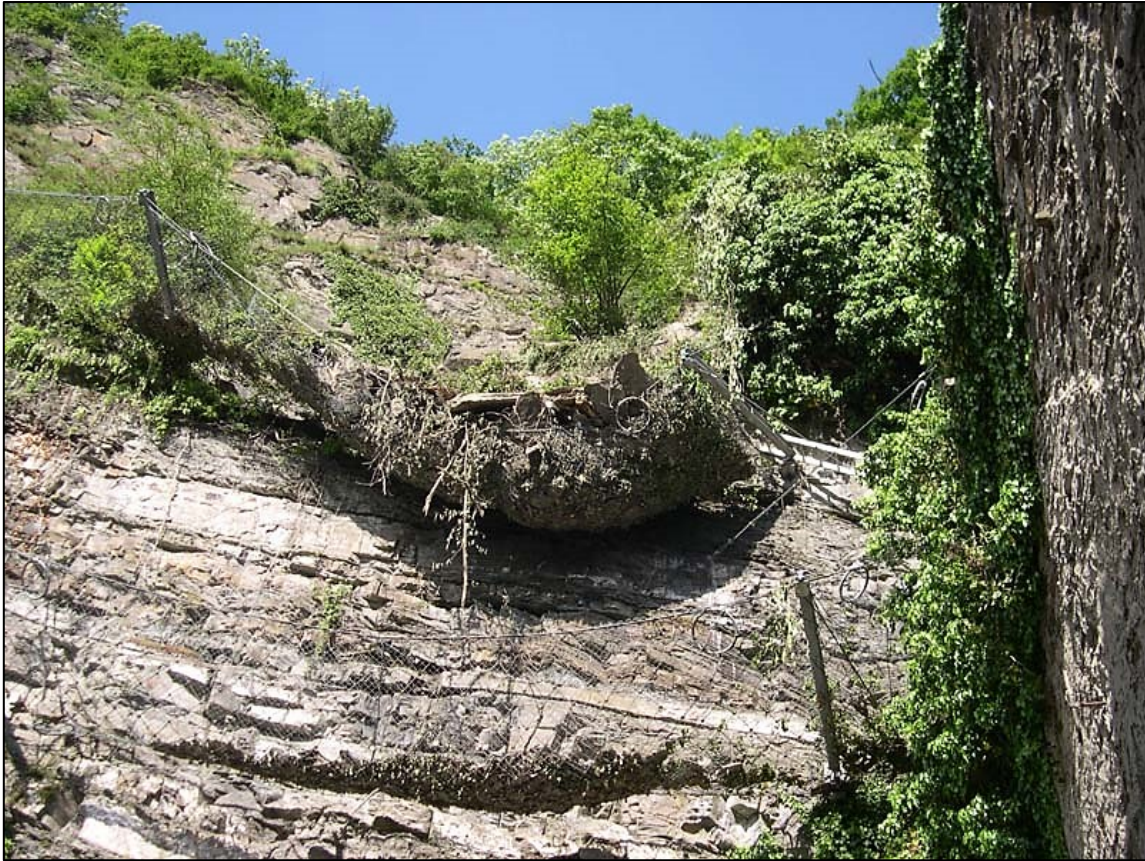
Abb. 55: Verfüllter Steinschlagfangzaun oberhalb des Rossteintunnels nach einem Felssturzereignis aus dem Jahr 2005 (Grunert & Hess 2010)
