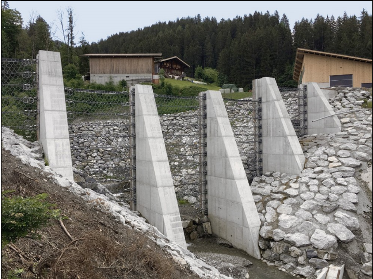
Abb. 22: Klassische alpine Murgangssperre als Kombinationsbauwerk aus Betonscheiben und gespannten Netzen in Sitebach an der Lenk (Kanton Bern 2021)
