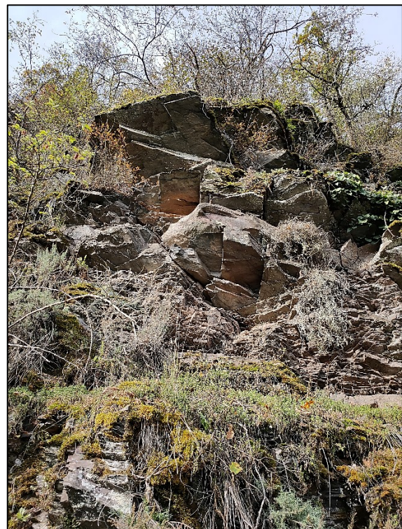
Abb. 84: Zerklüftete Felswand bei Cochem an der Mosel mit Anzeichen von rezente Ausbrüchen (Foto: T. Hagge-Kubat, 14.10.2020)
