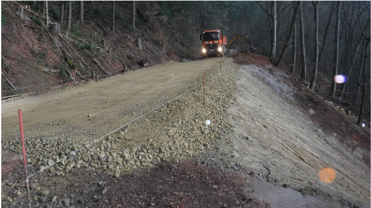
Abbildung 1: Foto der Rutschung nach ersten Sanierungsmaßnahmen. Zu erkennen ist wieviel der Straße dabei zerstört wurde (Foto: LBM RLP).
