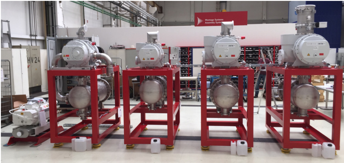
Abbildung 5.7: Die 5 Pumpen des subatmosphärischen Kompressorsystems des Testbunkers von der Firma Pfeiffer-Vacuum vor Montage im Pumpenraum. Die Anordnung ist identisch mit der endgültigen Aufstellung. Links befindet sich der Schraubenkompressor und daneben die 4 Rootspumpen mit jeweils einem darunter liegenden Gaskühler. Bild zur Verfügung gestellt von T. Stengler.
