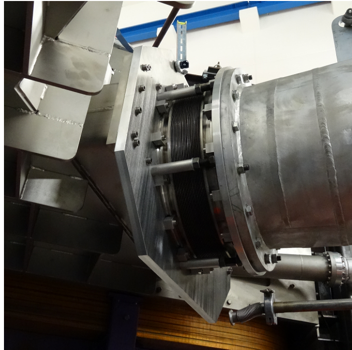
Abbildung 4.6: Die Vakuumkammer von KAOS (links) ist über einen Wellbalg mit der Ausgangsstrahlführung (rechts) verbunden. Damit sich der flexible Balg beim Abpumpen der Strahlführung nicht zusammenzieht, muss er von Abstandhaltern gestützt werden.
