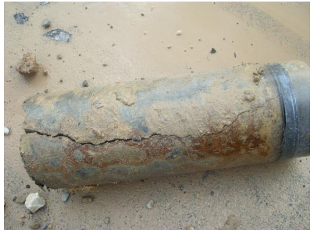
Longitudinal failure due high pressure
