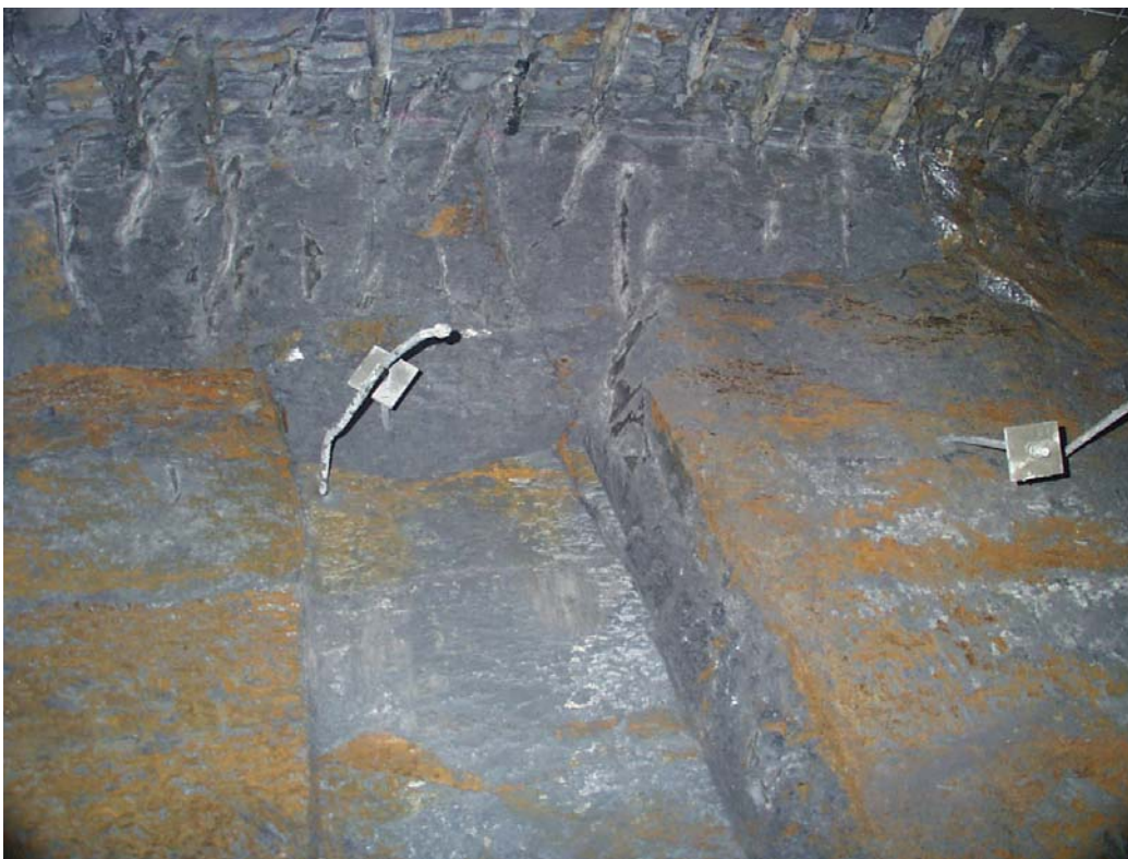
Abbildung 5-1: Gleitkeile durch den Verschnitt von dickbankiger Schichtung und Querklüften (mit Ortsbrustankern)
