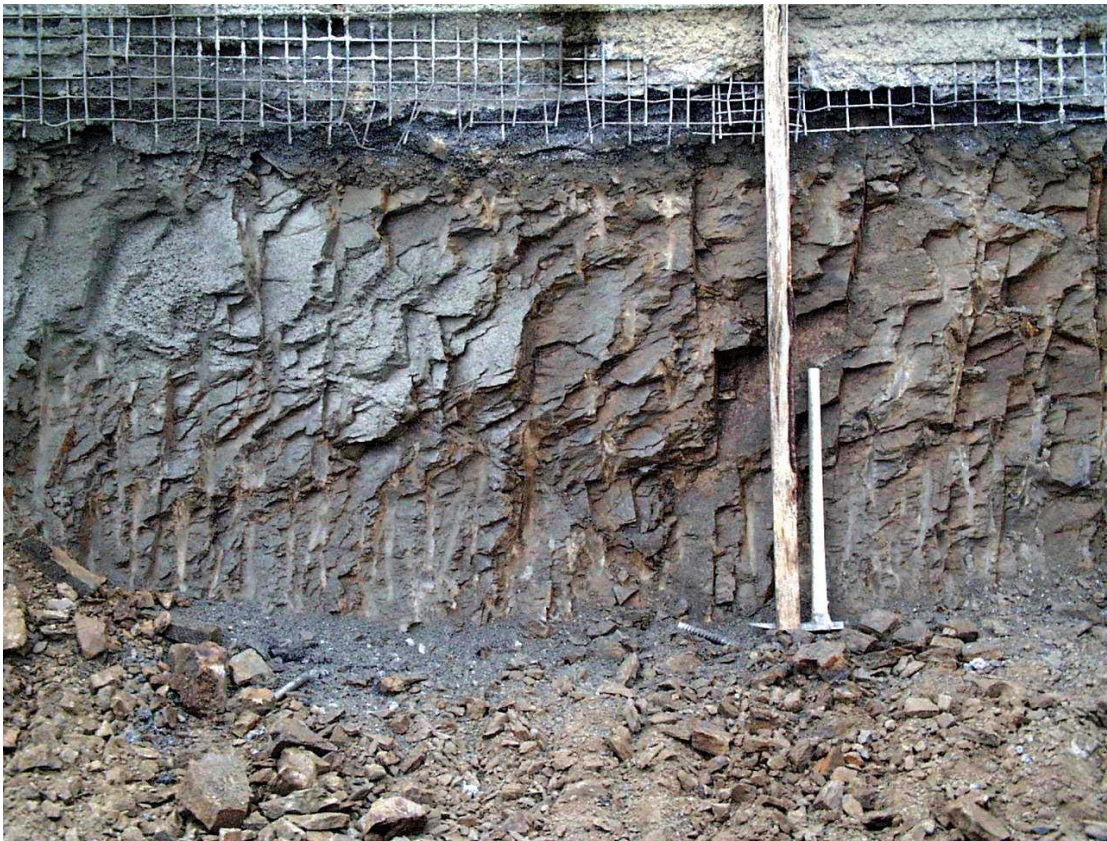
Abbildung 5-2: Engständige Schieferung in den Tonsteinen mit ungünstigem Einfallen zum Hohlraum
