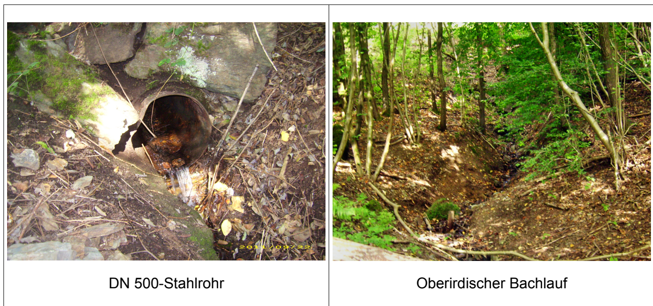
Abbildung 35: Oberirdische Entwässerung Sandberg Standort 2
