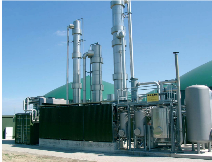
Abb. 4: Biogasaufbereitungsanlage in Ronnenberg. Im Hintergrund die zugehörige Biogasanlage. Quelle: FNR (2013).
